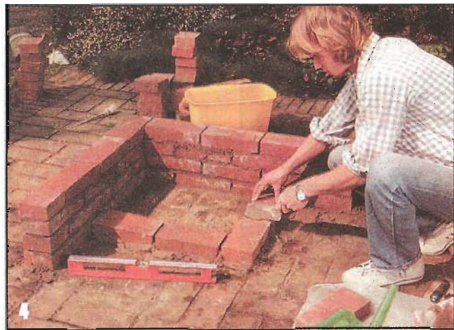
4 После укладки четырех рядов боковых стенок начинают класть собственно гриль. Каждый ряд проверяют по уровню.
